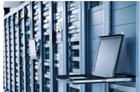
Racks de servidores
